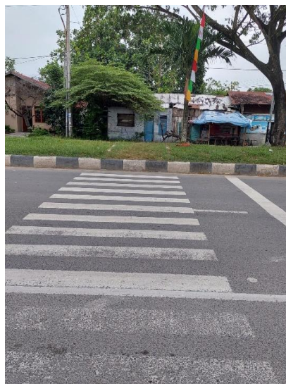
Gambar V. 9 Kondisi Marka Penyebrang Jalan Pada Ruas Jalan Sultan Serdang - KNO KM 10 - 11,4
