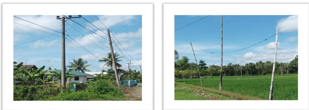
Gambar V. 35 Kondisi Eksisting Tiang Listrik Jalan Kajang – Sinjai II
