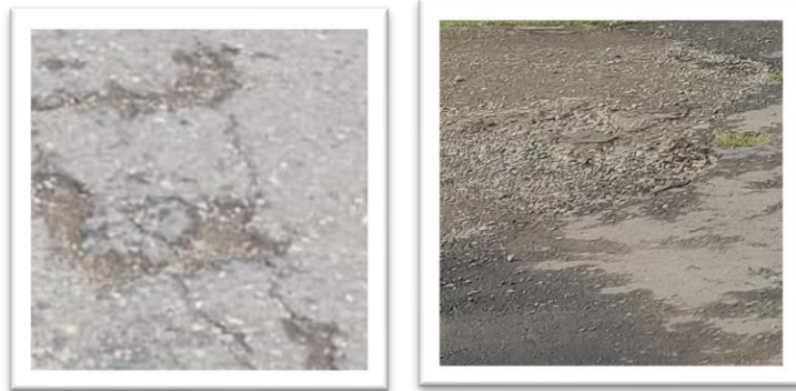
Gambar V. 17 Kondisi Kerusakan Permukaan Jalan Segmen 3
