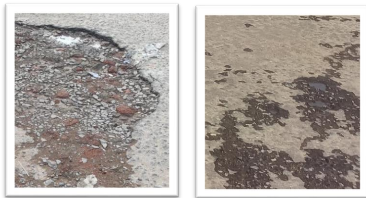
Gambar V. 29 Kondisi Kerusakan Permukaan Jalan Segmen 7
