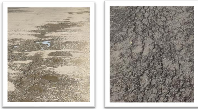
Gambar V. 26 Kondisi Kerusakan Jalan Segmen 6
