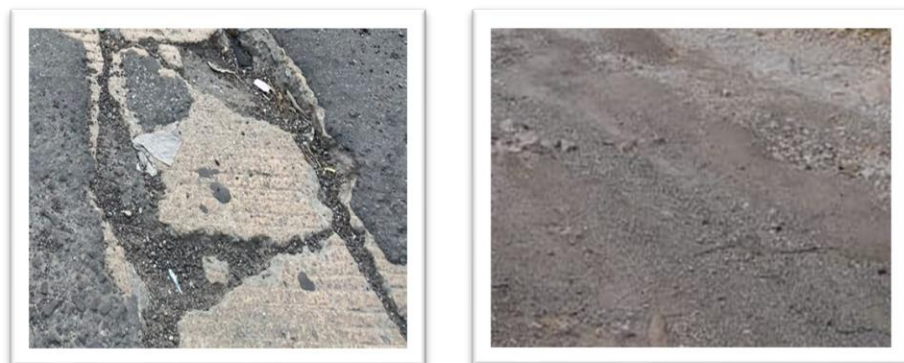
Gambar V. 11 Kondisi Kerusakan Permukaan Jalan Segmen 1
