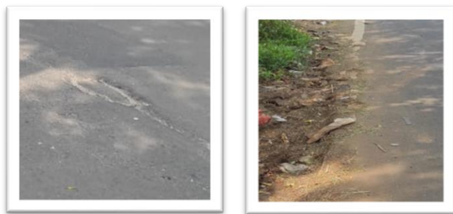
Gambar V. 20 Kondisi Kerusakan Permukaan Jalan Segmen 4
