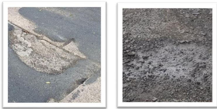
Gambar V. 14 Kondisi Kerusakan Permukaan Jalan Segmen 2
