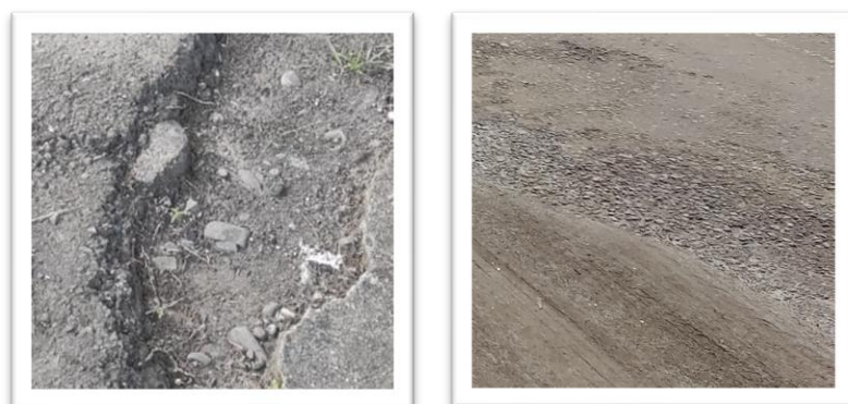
Gambar V. 32 Kondisi Kerusakan Permukaan Jalan Segmen 8
