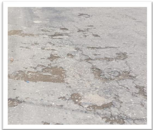
Gambar V. 36 Kerusakan Permukaan Jalan
