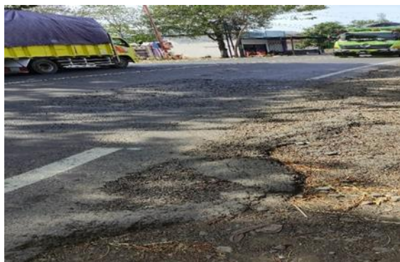
Gambar 5. 13 Perkerasan Jalan Yang Buruk Tikungan Situbondo 1
