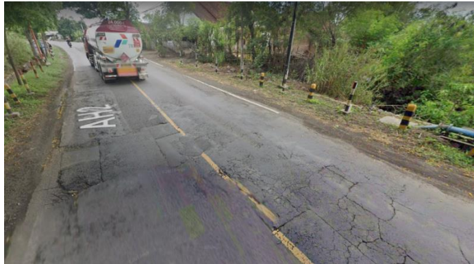
Gambar 5. 14 Perkerasan Jalan Yang Buruk Tikungan Situbondo 2
