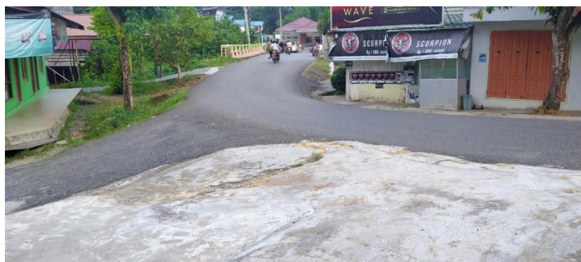
Gambar II. 10 Kondisi Jalan di Depan SMK Negeri 1 Kotabaru
