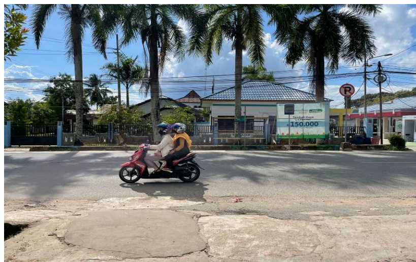
Gambar II. 14 Kondisi Jalan di Depan MAN Kotabaru
