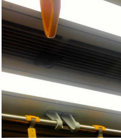
Gambar V.25 Fasilitas Penyejuk Udara
