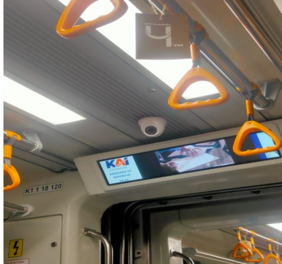
Gambar V.24 Kamera CCTV Yang Tidak Berfungsi
