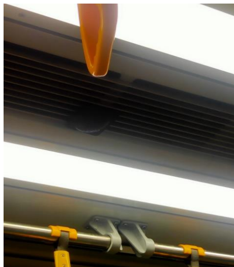
Gambar V.17 Fasilitas Penyejuk Udara
