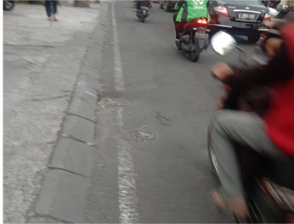
Gambar 5.3 : Visualisasi Marka Membujur Garis Utuh Tanda Tepi Jalur Pada Ruas Jalan Kaliurang KM 4 – KM 5,6 di Kabupaten Sleman
