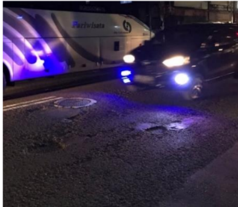
Gambar 2.4 : Visualisasi Pengerasan Jalan yang Rusak
