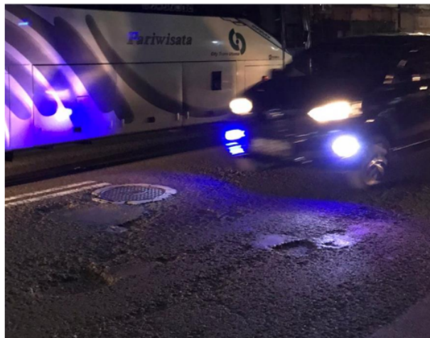
Gambar 5.7 : Visualisasi Kondisi Perkerasan Jalan Pada Ruas Jalan Kaliurang KM 4 – KM 5,6 di Kabupaten Sleman
