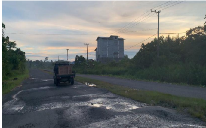
Gambar V. 6 Kondisi perkerasan jalan yang rusak berlubang
