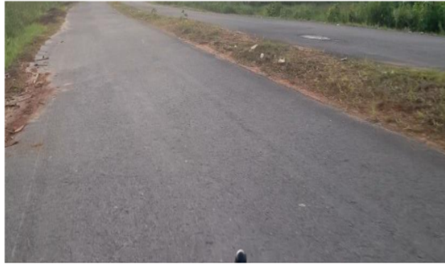
Gambar V. 2 Kondisi jalan yang tidak terdapat marka
