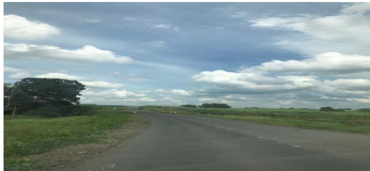
Gambar 5 9 Marka Yang Sudah Tidak Jelas
