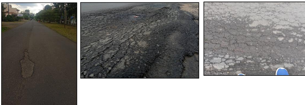
gambar 2. Perkerasan Jalan yang Rusak
