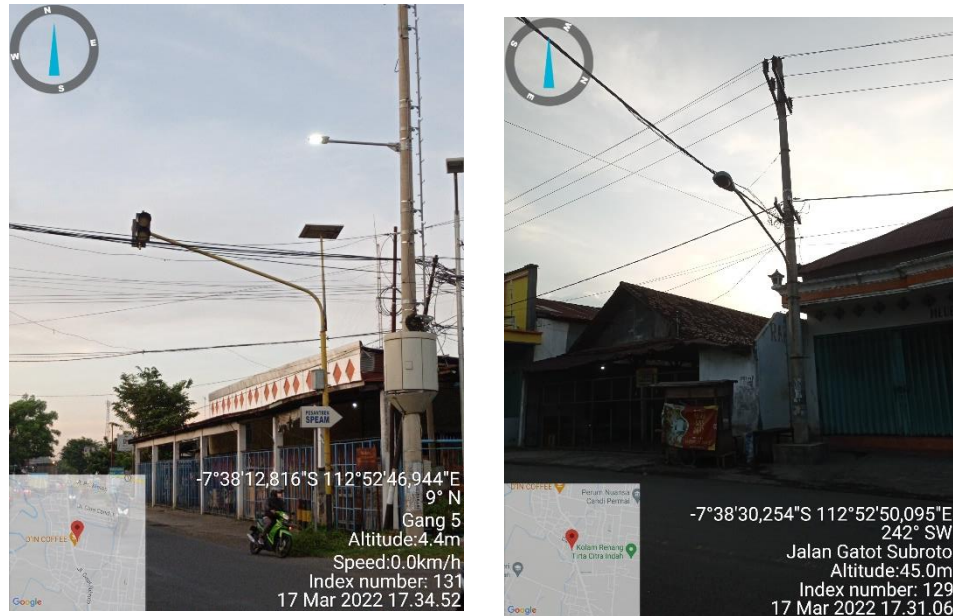
Gambar V. 10 Kondisi Penerangan Lampu Jalan
