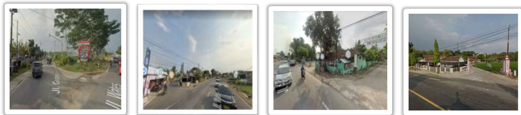
Gambar V. 41 Kondisi eksisting tiap segmen pada persimpangan terdapat marka tepi yang sudah memudar
