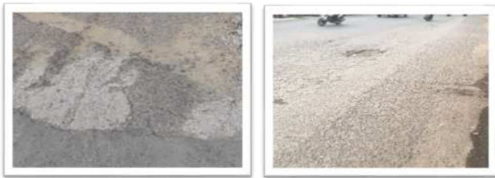
Gambar V. 17 Kondisi permukaan jalan segmen 3
