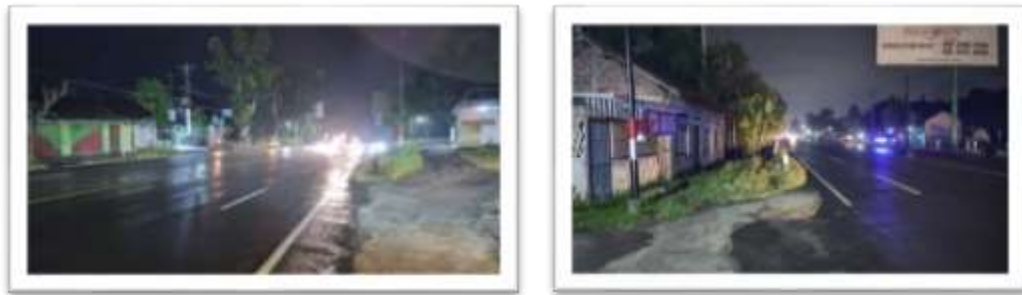
Gambar V. 20 Kondisi lampu penerangan jalan segmen 4
