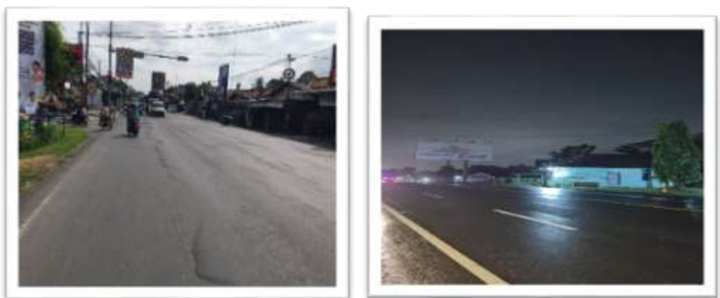
Gambar V. 14 Kondisi lampu penerangan jalan dan kerusakan jalan segmen 2
