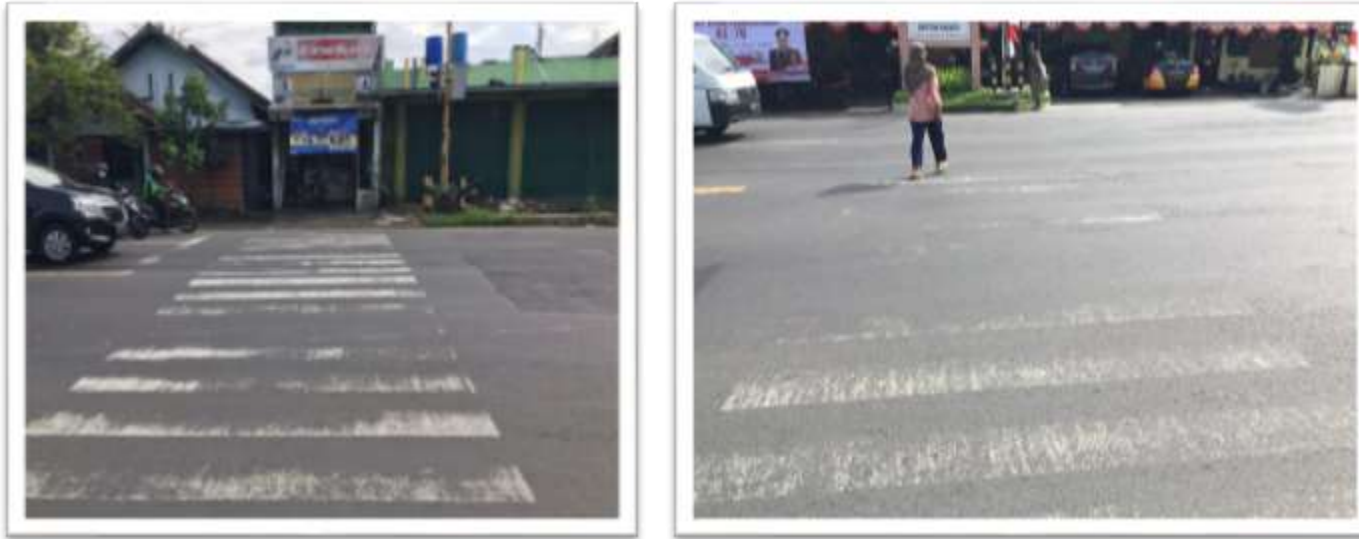
Gambar V. 42 Kondisi eksisting Pada Segmen 1 dan 3 tidak terdapat Rambu Penyebrangan
