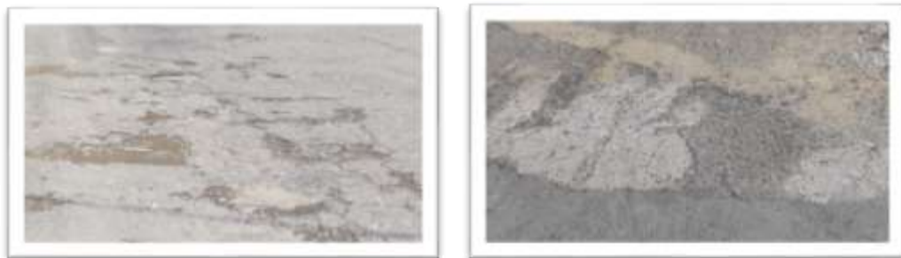
Gambar V. 11 Kondisi Kerusakan Permukaan Jalan Segmen 1
