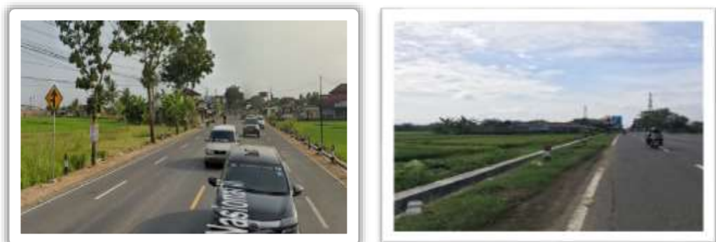
Gambar V. 16 Kondisi marka jalan dan kondisi bahu jalan segmen 3
