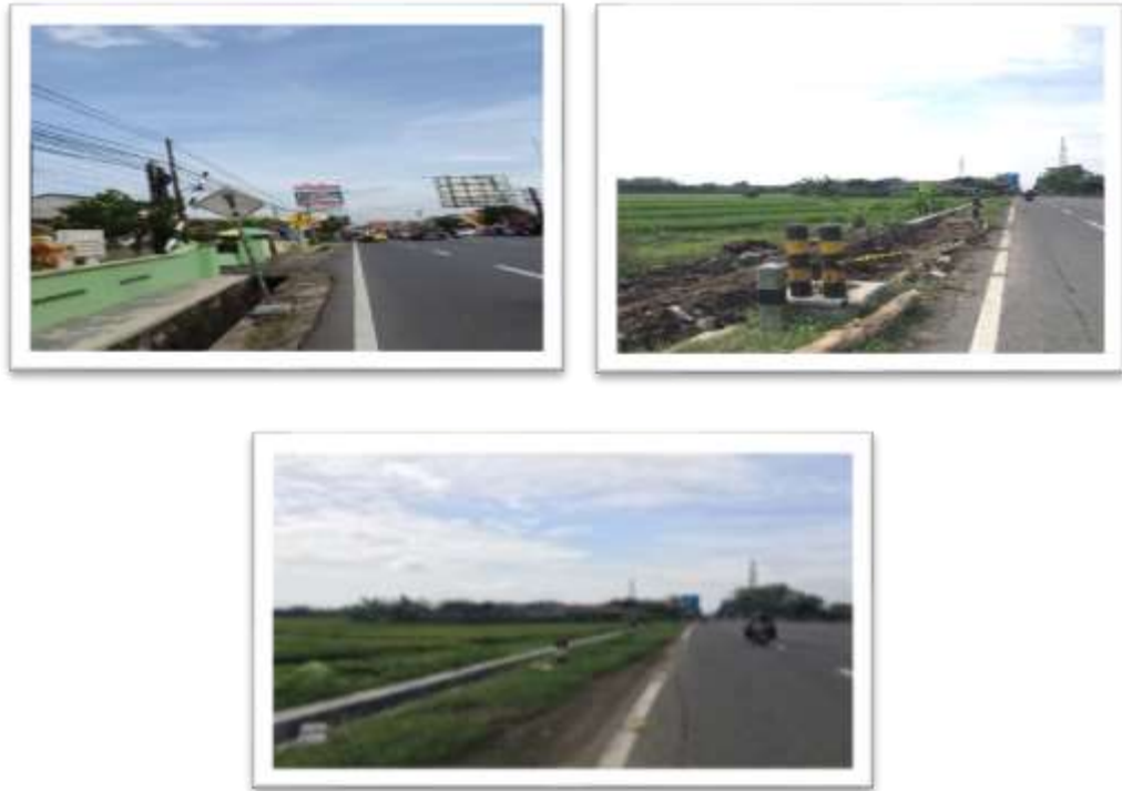
Gambar V. 22 Kondisi Eksisting Saluran Tepi Jalan Wates - Yogya
