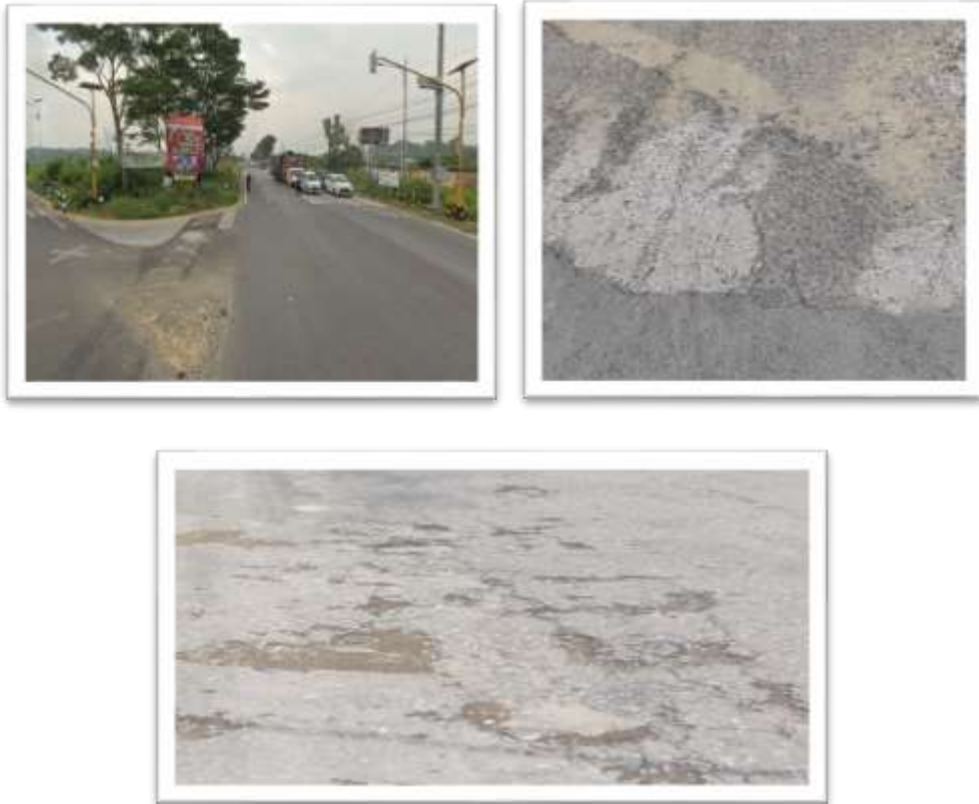
Gambar V. 24 Kerusakan Permukaan Jalan
