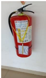
Gambar II. 4 Alat Pemadam Kebakaran
