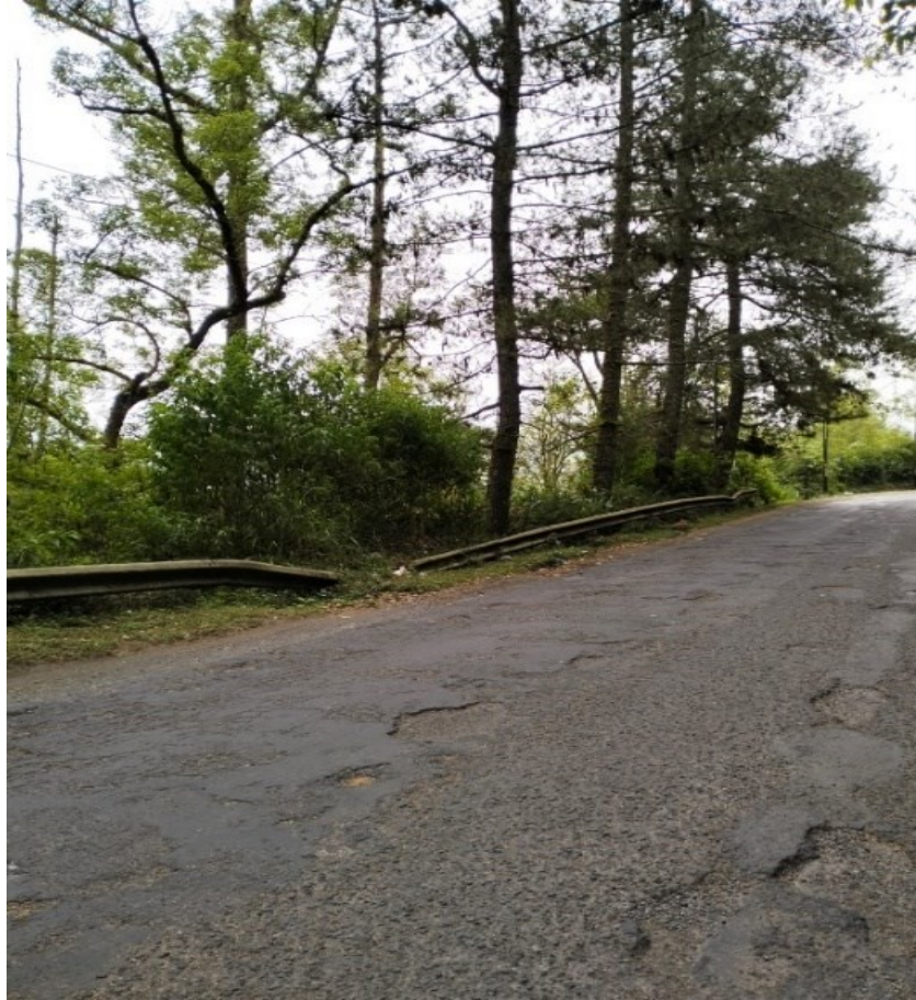
Gambar 2. 4 Jalan berlubang dan tidak rata
