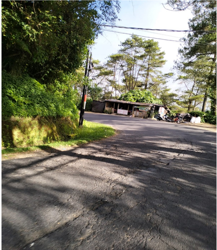
Gambar 2. 5 Jalan berlubang dan tidak rata
