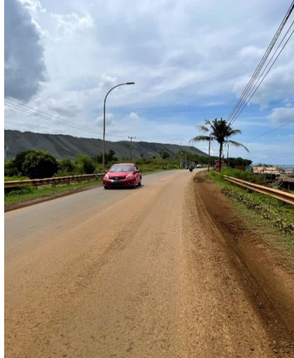
Gambar II.7 Kondisi jalan dengan marka yang memudar
