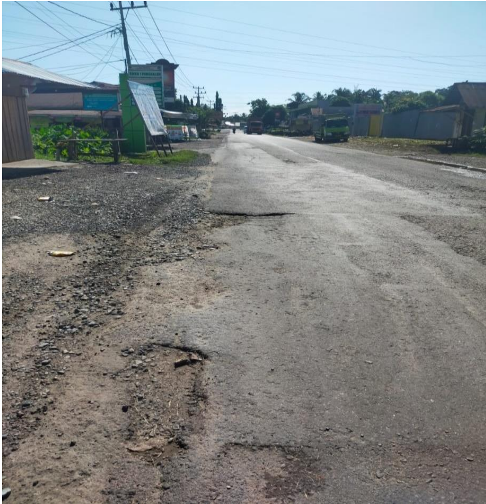
Gambar II. 3 Kondisi Ruas Jalan Lintas Sumbar-Riau Km 175
