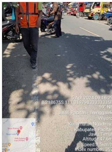
Gambar II. 7 Kondisi Marka Di Ruas Jalan Bts. Kab. Pacitan – Trenggalek 9
