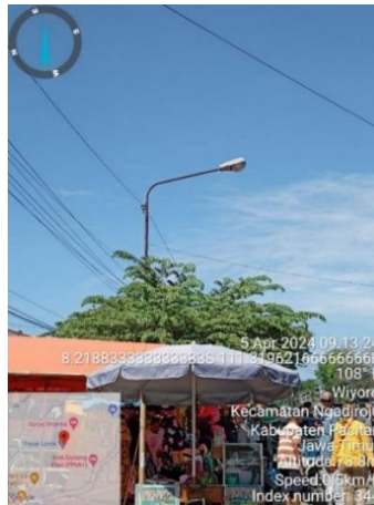
Gambar II. 9 Kondisi Penerangan Jalan Umum (PJU) Di Ruas Jalan Bts. Kab. Pacitan – Trenggalek 9
