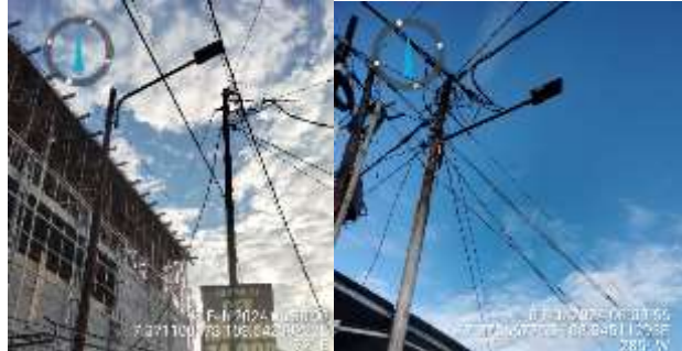
Gambar II. 2 Kondisi Penerangan Jalan
