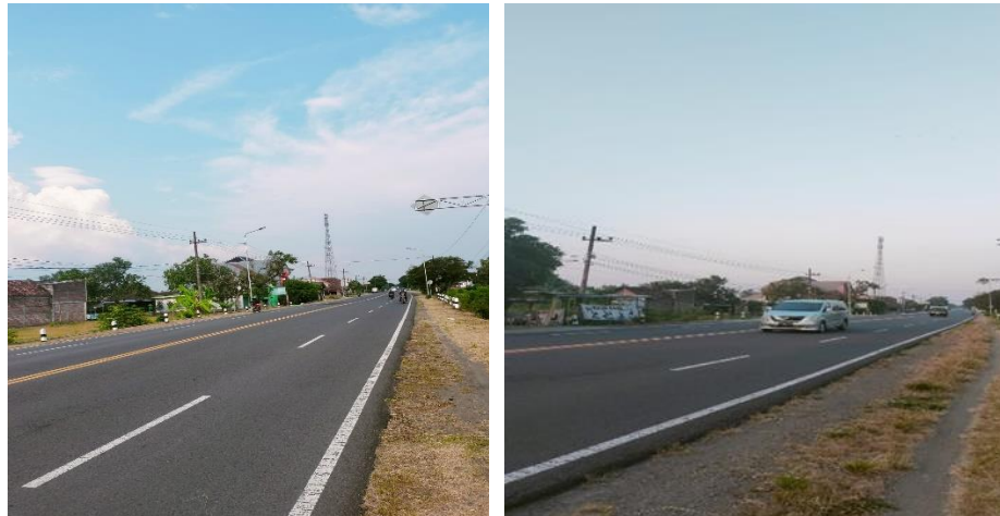
Gambar II. 6 Kondisi Marka Berdasarkan Survei
