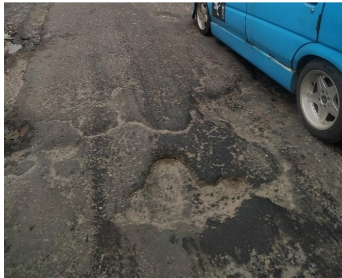
Gambar II. 3 Kondisi Perkerasan Jalan
