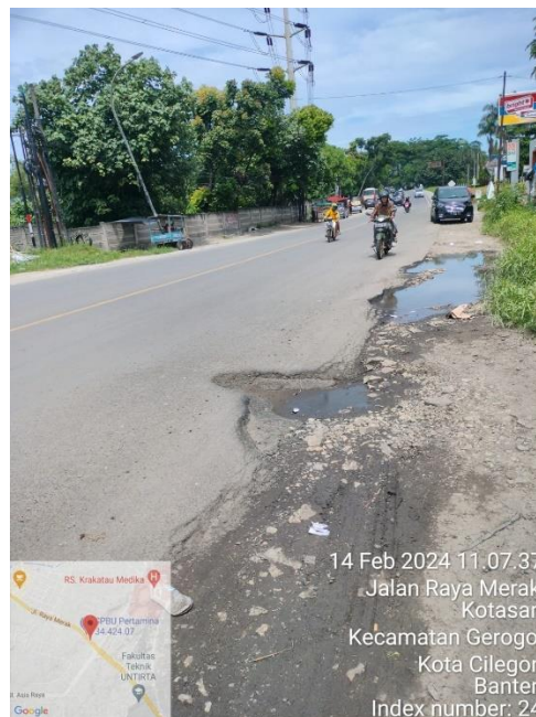
Gambar II. 4 Kondisi Ruas Jalan Raya Merak
