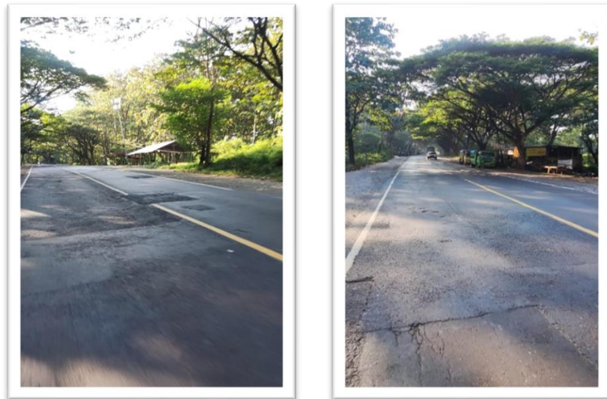
Gambar II. 8 Kondisi Eksisting Permukaan Jalan
