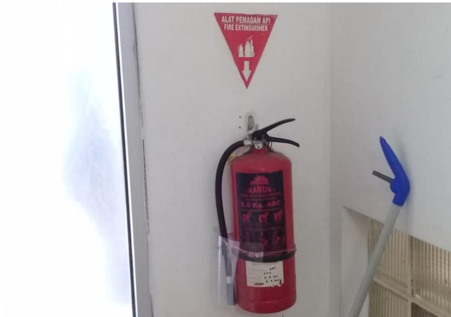
Gambar II. 15 Alat Pemadam Kebakaran di Balai Pengujian Perkeretaapian
